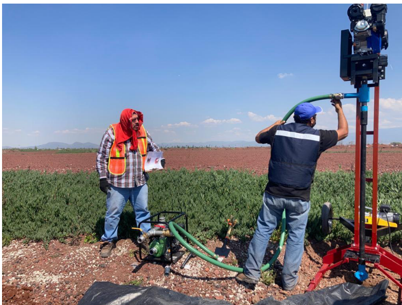
Figura 22. Conexiones hidráulicas hacia la tubería de perforación.
