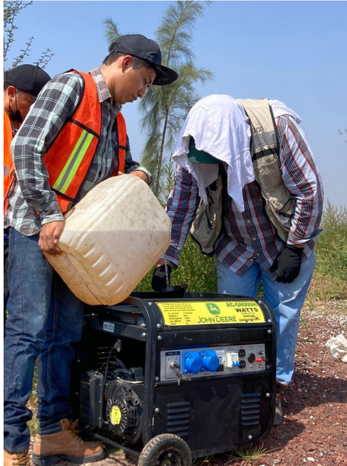
Figura 9. Planta eléctrica utilizada para la perforación.
