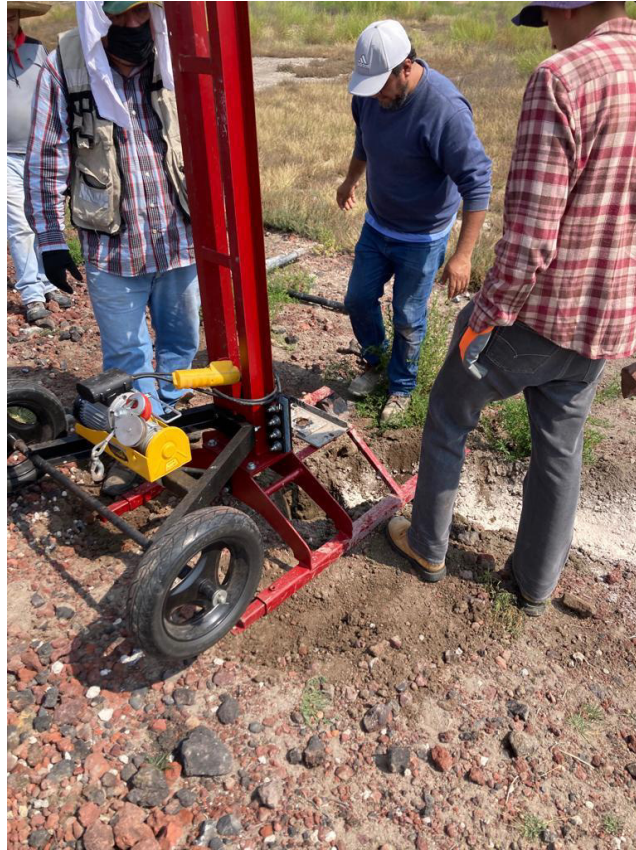
Figura 4. Malacate eléctrico instalado en el soporte del equipo.
