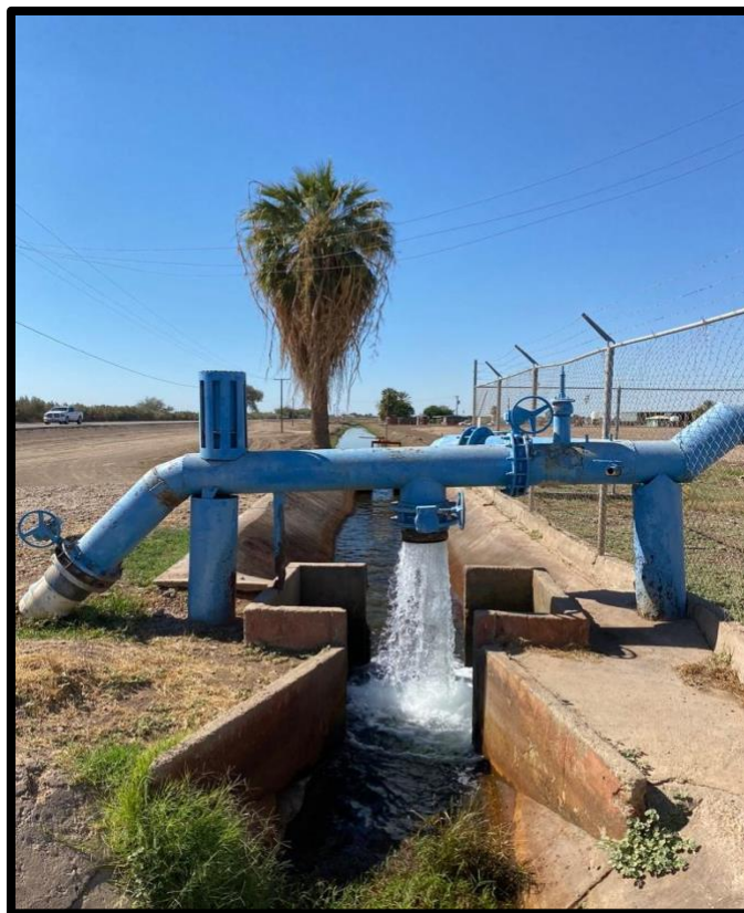
Fig. 64 Pozo de riego. Distrito de Riego 014 Valle de Mexicali, B.C. Autor: Gonzalo Hatch Kuri.
